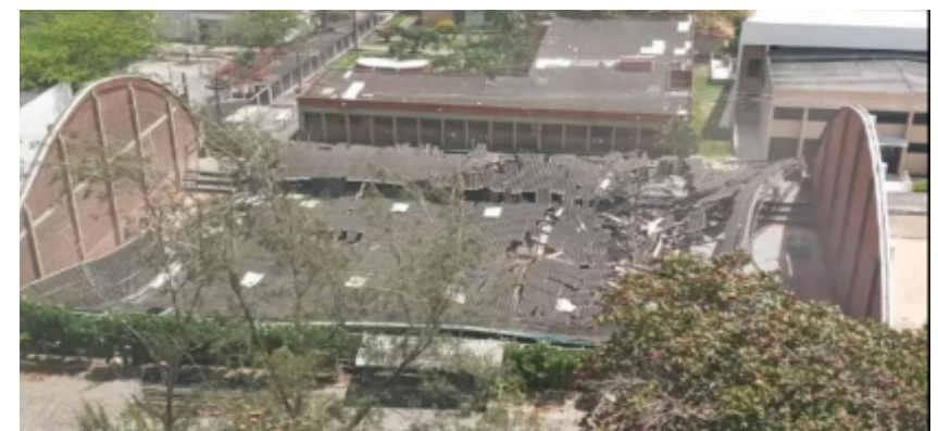
Ilustração 2–Desabamento de teto do Ginásio Poliesportivo da UFCG–CG em 2021
