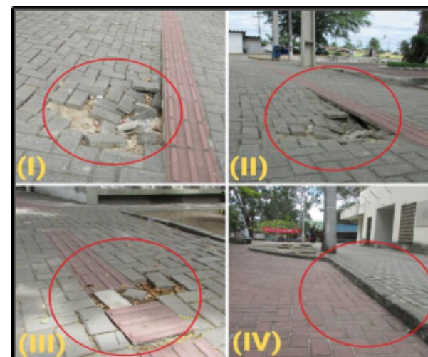
Ilustração 34–Pontos danosos e/ou fora da Norma
