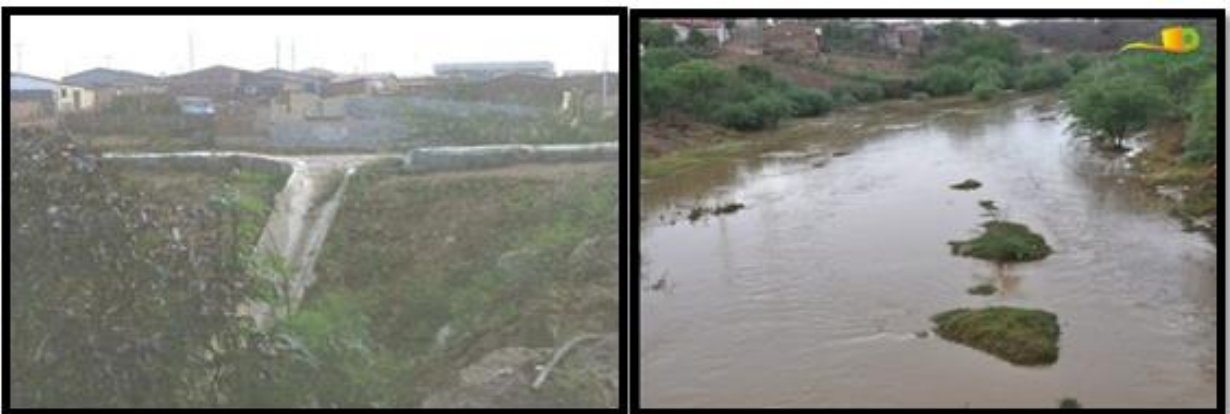
Figura 4- Canaleta de escoamento de água pluvial para o Riacho dos Mourões no bairro Chico Pereira
